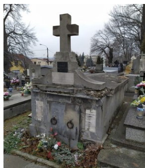
Grób przed remontem. Fot. IPN
