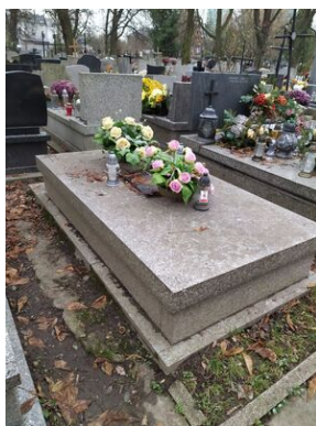
Grob przed remontem
